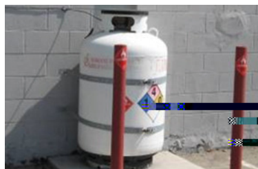
Réservoir de liquide inflammable fixé au mur par des sangles
